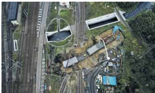
Budowa tunelu pieszo-rowerowego przy ul. Częstochowskiej w Tarnowskich Górach miała kosztować 11 mln zł. To już nieaktualne
