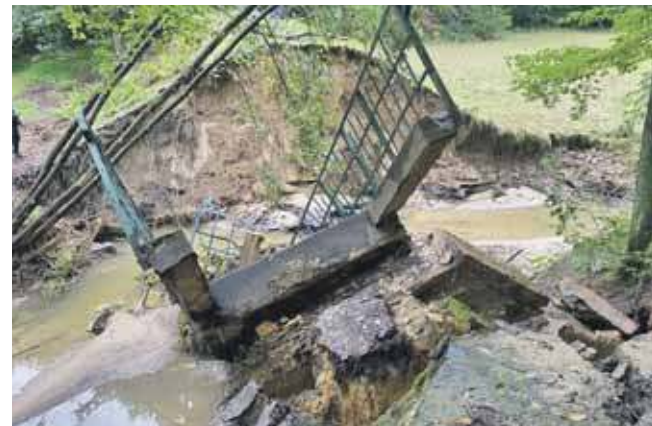
Tyle zostało z mostu w parku Repeckim po przejściu nawałnicy
