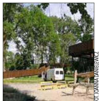
Zniszczona przez drzewo konstrukcja ścieżki wśród drzew została naprawiona
