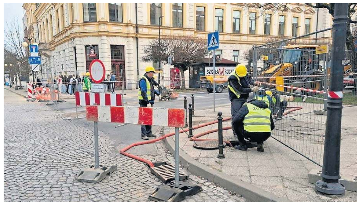
We wtorek zamknięto część ulicy Sienkiewicza. Trwają prace przy usuwaniu awarii sieci ciepłowniczej.
