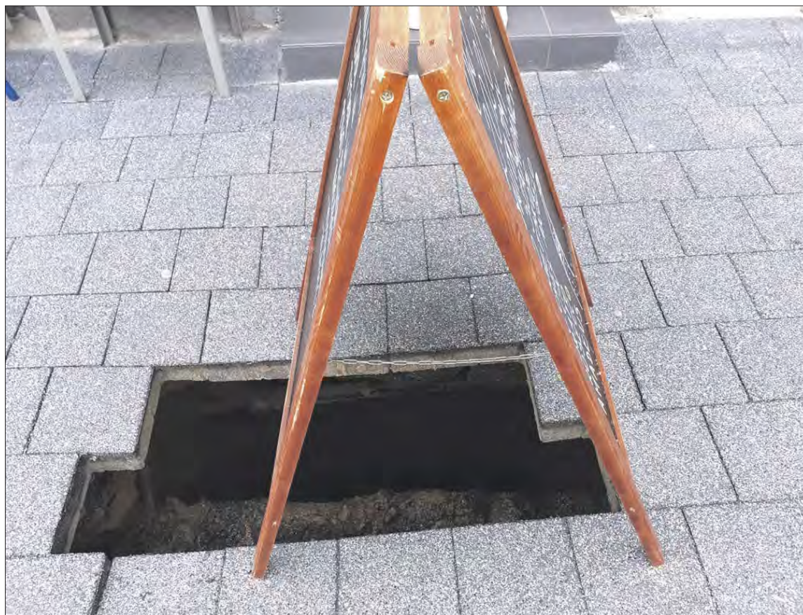
Dziura pod bialskim Rynkiem powstała na chodniku przed wejściem do sklepu monopolowego. Otwór został zabezpieczony.
