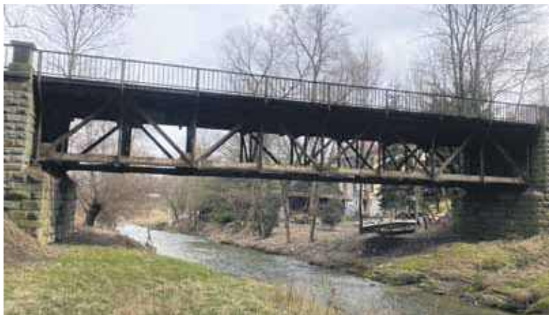
Stary most jest w fatalnym stanie technicznym.
