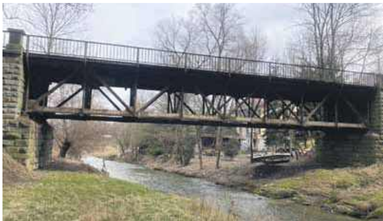
Stary most jest w fatalnym stanie technicznym.
