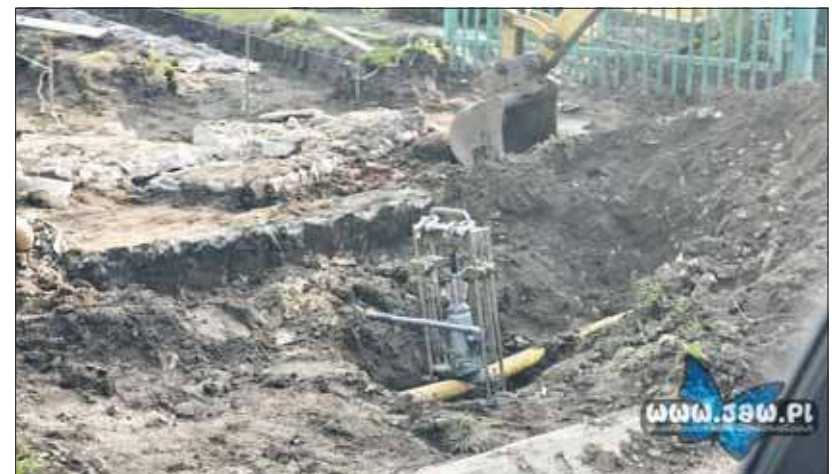
Uszkodzony gazociąg na ulicy Chrzanowskiej
