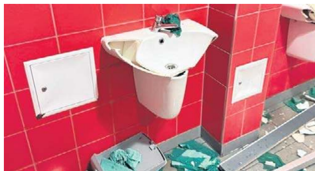
Tak wyglądały łazienki (i całe zaplecze) sektora gości na stadionie Widzewa Łódź po wycieczce fanów Lecha Poznań. Straty są szacowane, ale kwota będzie potężna
