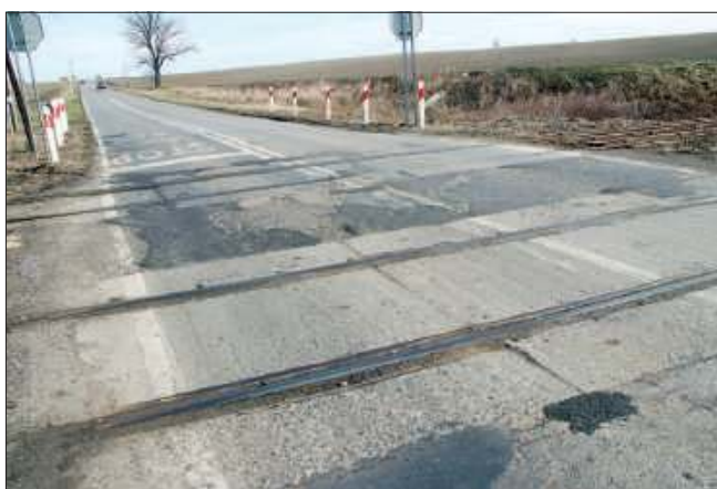
Przejazd jeszcze będzie musiał poczekać na generalny remont
