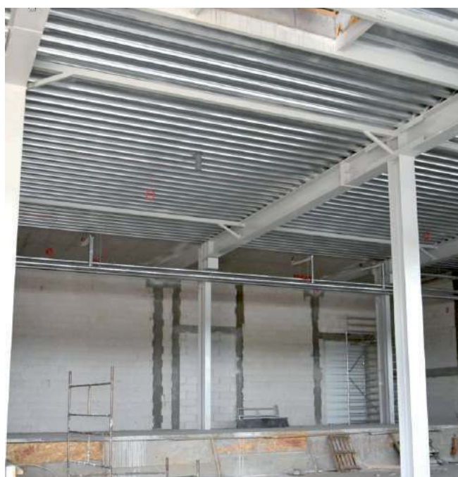
Poszkodowany mężczyzna pracował przy stropie hali i „wypadł” przez znajdujący się w podłożu tzw. otwór technologiczny
