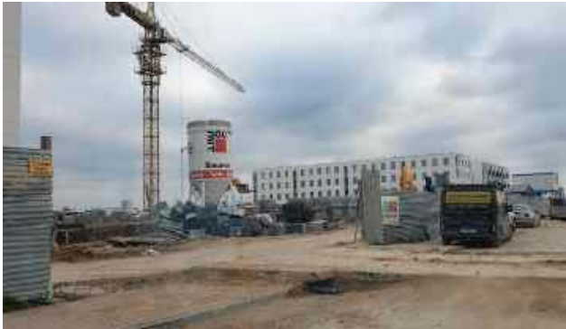
Czy droga z betonowych płyt, po której jeździ ciężki sprzęt budowlany nie uszkodzi położonego niedawno asfaltu? Władze miasta zapewniają, że obawy są na wyrost
