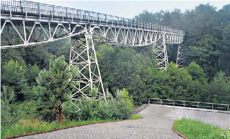
Gmina planuje naprawę na moście dawnej kolejki wąskotorowej w Koronowie. Na czas robót przeprawa będzie zamknięta
