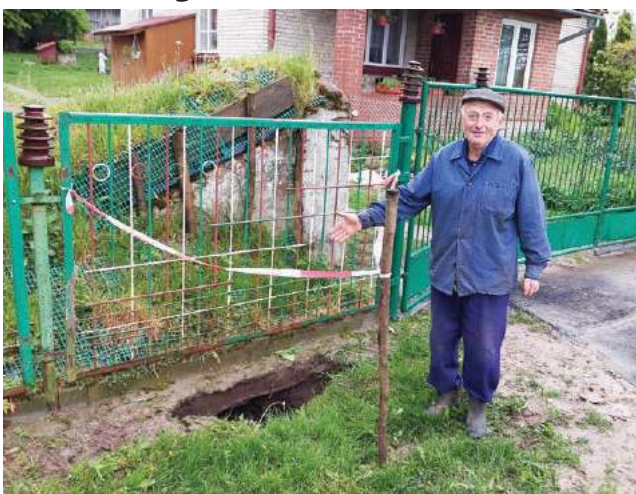
- Woda wdarła się do zewnętrznej piwnicy od strony przebudowanej drogi - pokazuje Roman Kołodziej
