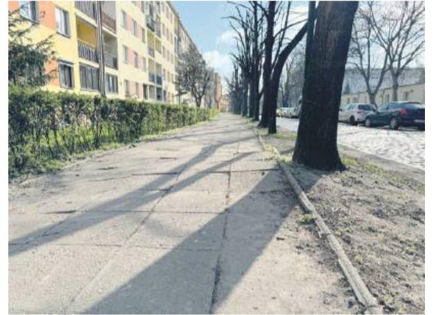
Chodnik przy ul. Staszica w Strzelinie jest w złym stanie. Korzenie drzew podnoszą betonowe płyty, tworząc liczne nierówności
