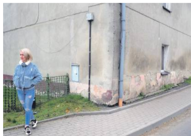
Odpadający tynk z elewacji domu przy drodze wojewódzkiej. Zabezpieczeniem ma się zająć DSDiK w Wrocławiu
