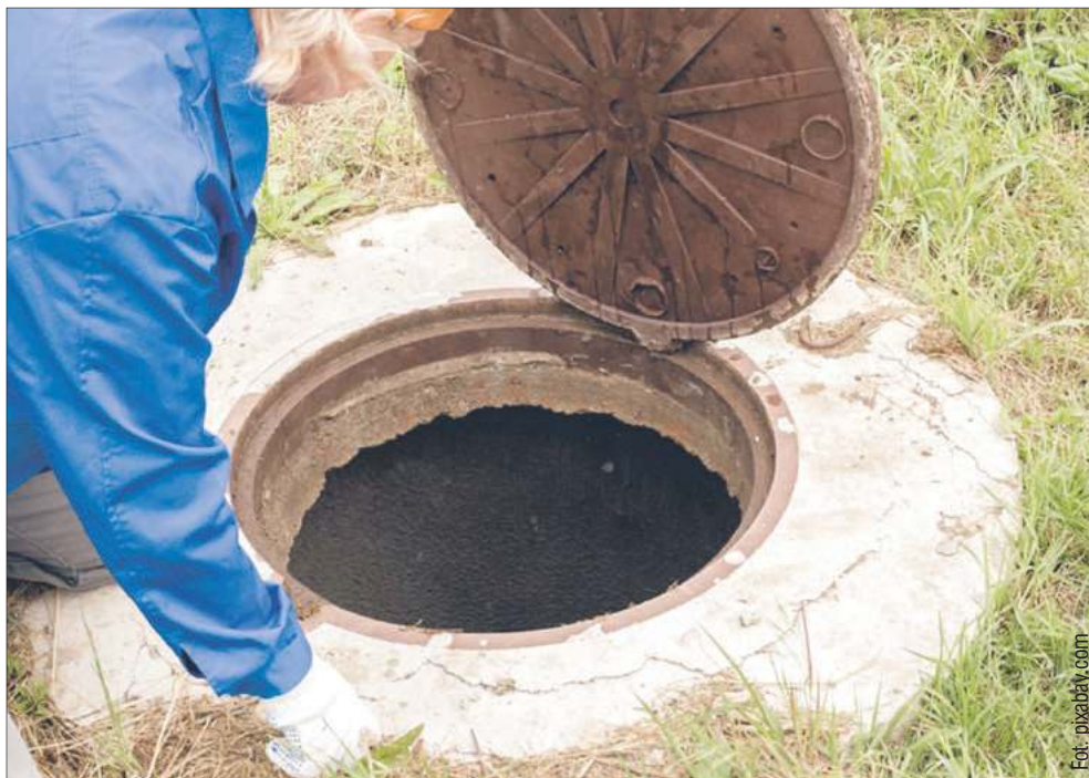
Urząd zapowiada ponowne kontrole dotyczące przydomowych oczyszczalni ścieków i szamb.
