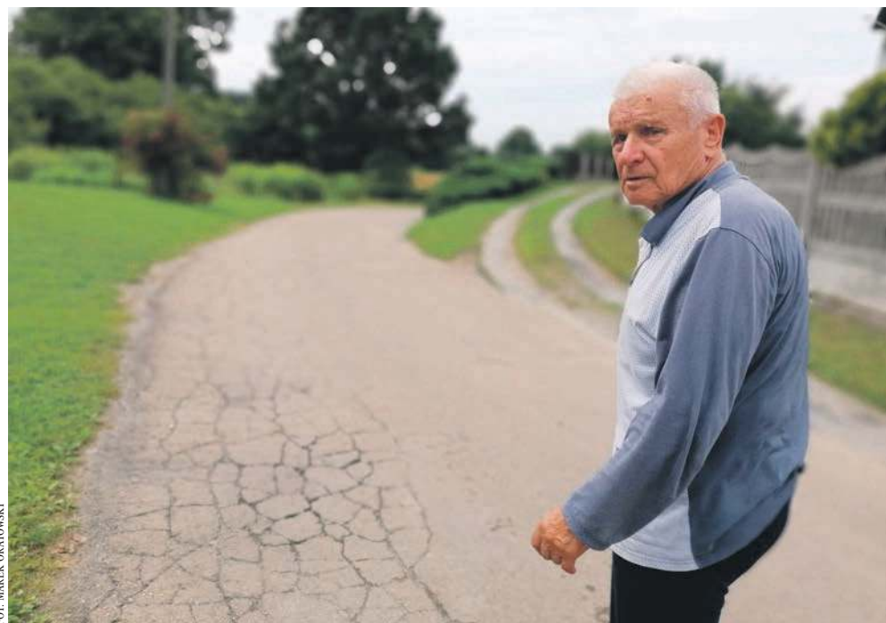
Stanisław Jurczyk jest jednym z mieszkańców zabiegających o remont popękanej i wąskiej ulicy Krańcowej
