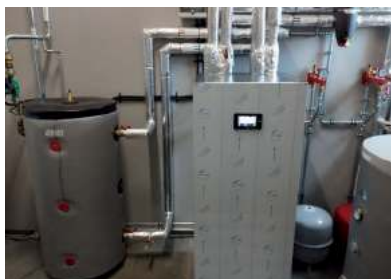
Gruntowa pompa ciepła w budynku Świetlicy Wiejskiej w Jabłoni
