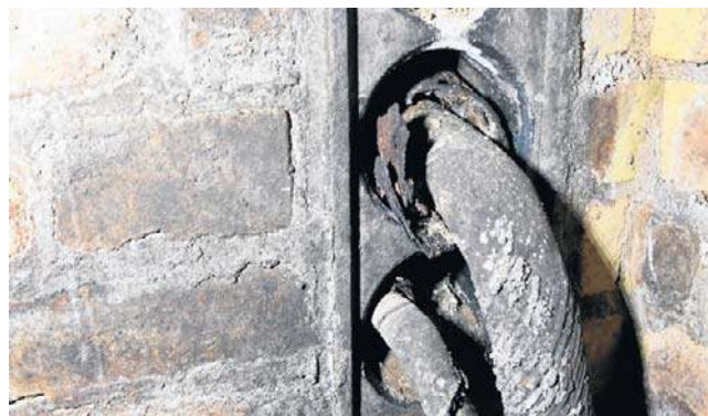
Z jednej ze ścian piwnicy wciąż wystaje około metrowej długości, niemiecki kabel.
