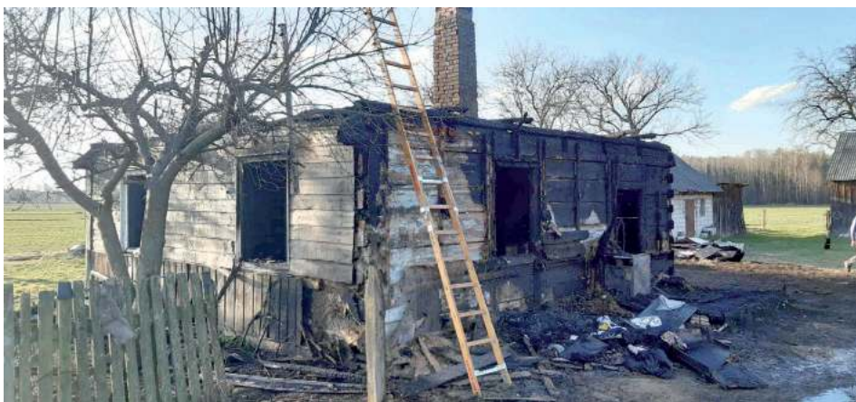
Śniadówka: Drewniany dom płonął jak pochodnia. To, co z niego zostało, nadaje się tylko do rozbiórki
