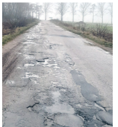
Droga w Gałkach przed renowacją
