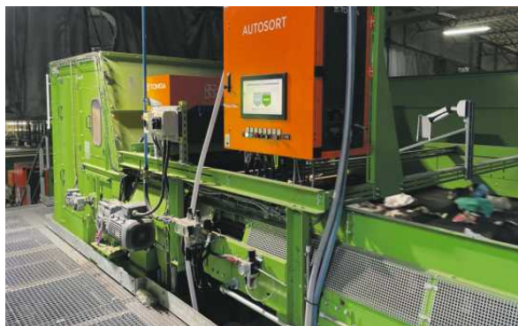
Sortownia odpadów komunalnych w ZUT Gdańsk
