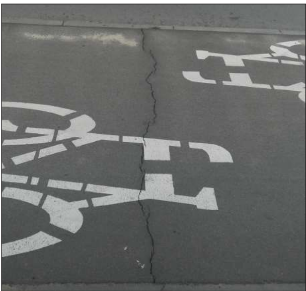
■ W Dęblinie i Rykach na ścieżkach rowerowych pęka asfalt. Są obawy, że nawierzchnia nie przetrwa kolejnej zimy czasu. Na obu odcinkach pojawiły się ubytki oraz pęknięcia przez całą szerokość. Tylko w Rykach jest ich ponad 50. W Dęblinie liczba jest podobna. - Bez dwóch zdań jest problem z nawierzchnią. Zgłosiłem
