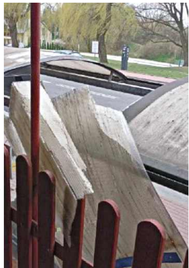
Mężczyzna wszedł na wiatę autobusową przy ulicy Traugutta. Konstrukcja nie wytrzymała obciążenia, w wyniku czego doszło do zawalenia dachu
