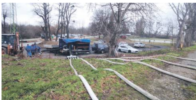
Podjęto decyzja o przepompowaniu zgromadzonej wody deszczowej
