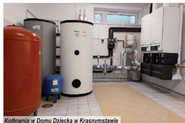
Kotłownia w Domu Dziecka w Krasnymstawie
