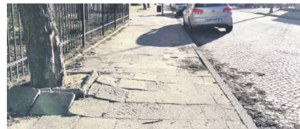
Chodnik przy ul. Mickiewicza w Strzelinie czeka gruntowny remont
