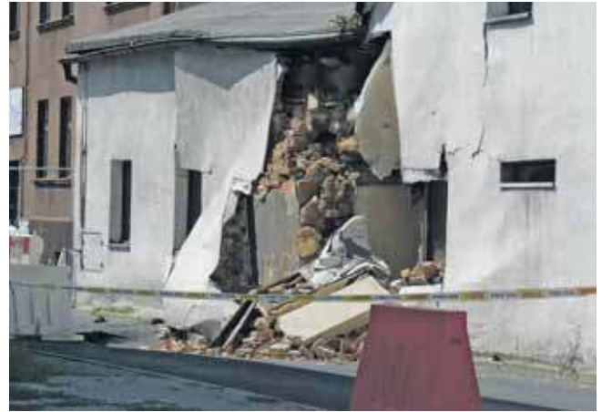
W rejonie skrzyżowania ulic Królika i Dolnej pojawiły się zapadliska i w lipcu zawaliła się ściana budynku restauracji Kurna Chata
