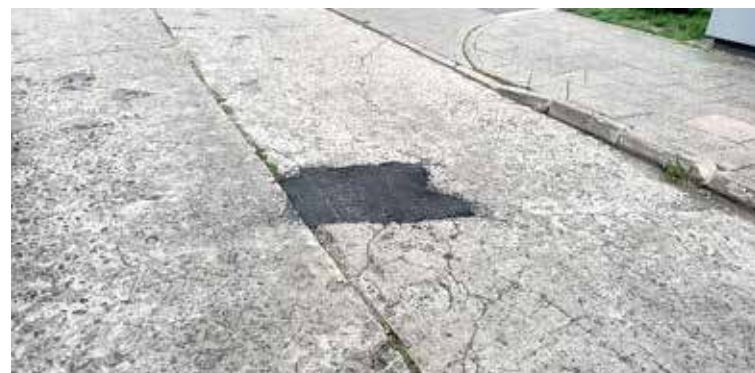
Jedna ze świeżych asfaltowych łat
