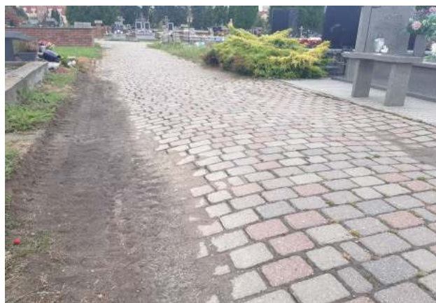
Nierówności powstały po stronach obu chodnika (zdjęcie wykonane we wtorek, 27 czerwca)
