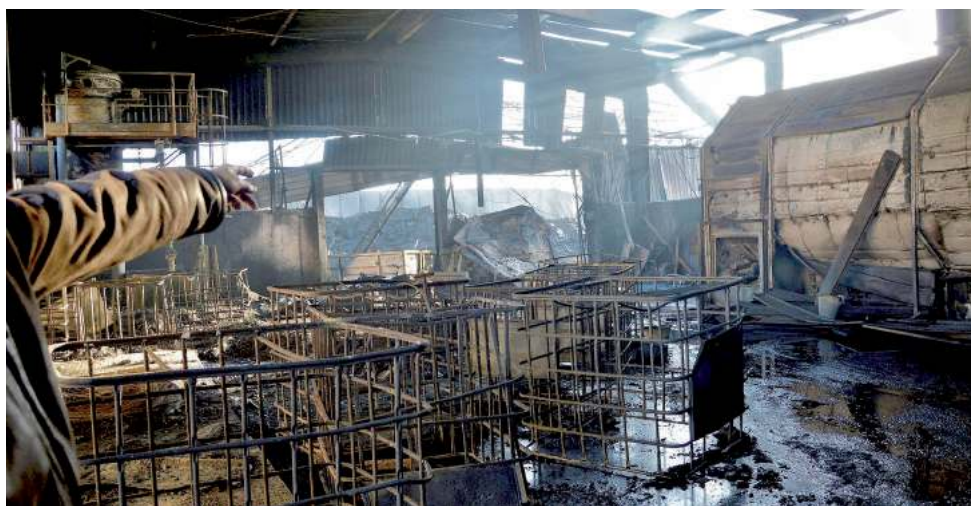
W wyniku eksplozji uległa zniszczeniu cała linia technologiczna: magazyny, hala, po prostu wszystko! - mówi właściciel
