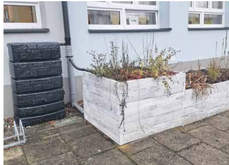
Zbiornik na deszczówkę zamontowany przy Szkole Podstawowej nr 9 w Tarnowskich Górach
