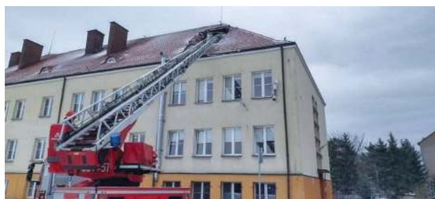
Wichura uszkodziła jeden z kominów. Jak się okazuje należy przebudować wszystkie
