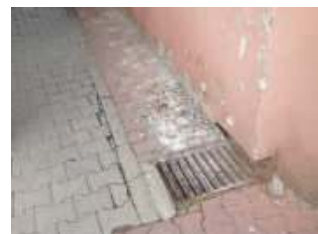
Studzienka kanalizacyjna przy ścianie mieszkania zwiększa poziom zawilgocenia
