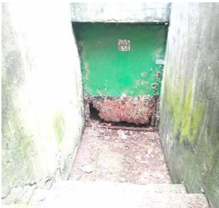
Patrząc z bliska można łatwo dostrzec, że drzwi wejściowe są do połowy zniszczone rdzą
