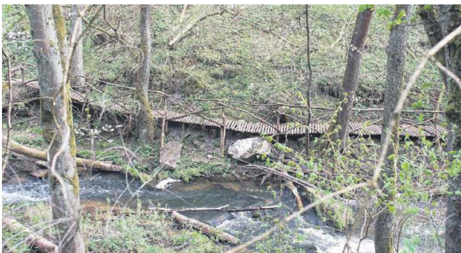
Pomosty, kładki i schody na Czartowym Polu czekają na remonty.
