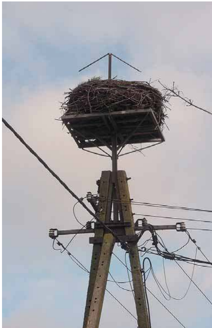
Słup energetyczny w Wieczfnia K. z bocianim gniazdem, na którym ktoś umieścił przeszkodę
