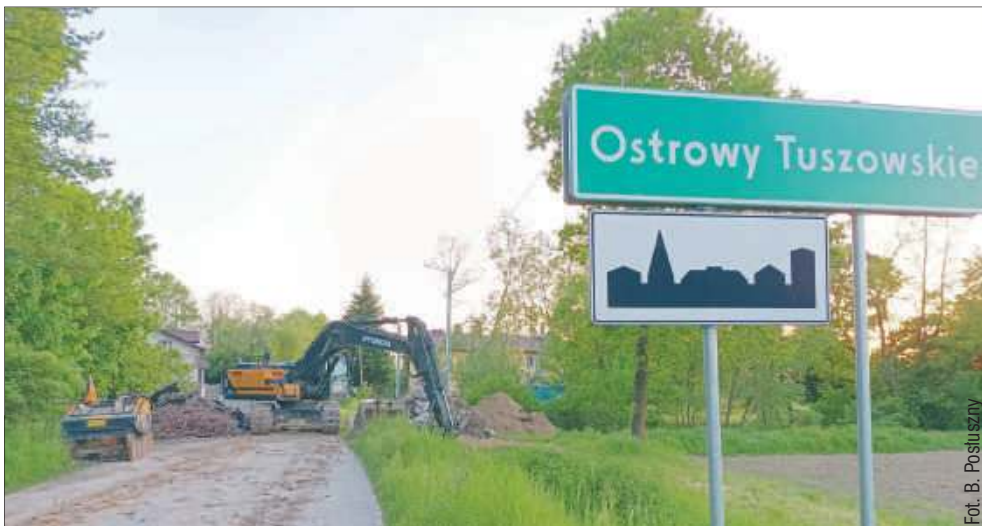
Mieszkańcy okolicznych miejscowości podpisali się pod petycją dotyczącą budowy mostu zastępczego.
