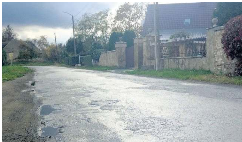
Odcinek drogi w Gościęcicach Dolnych jest w złym stanie technicznym
