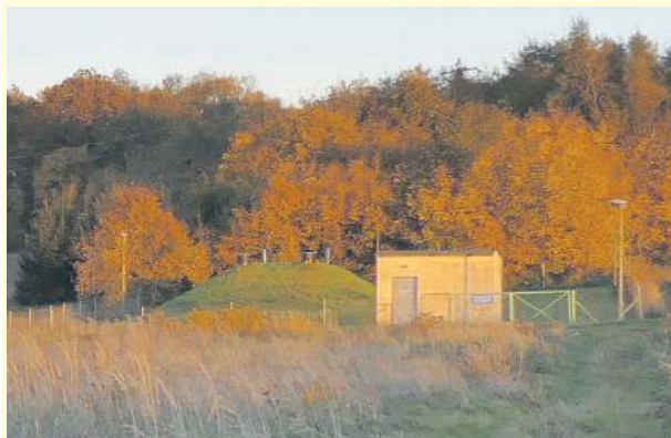
Studnia głębinowa w Dobroszowie umiejscowiona jest za byłą szkołą. Stamtąd pompy tłoczą wodę do zbiorników na boisku pod Kalinką. Ujęcie to miało zasilać tylko jedną wieś, a tymczasem podłączonych jest do niego sześć miejscowości
