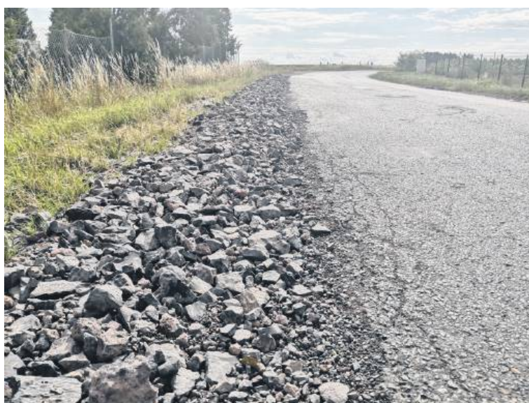
Wielkość kruszywa wykorzystanego do utwardzenia pobocza przy drodze z Prus zaniepokoiła kierowców
