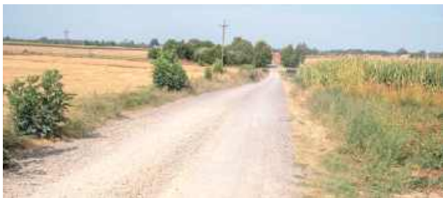
Obecny stan drogi w Leopoldowie
