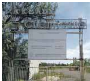
Ostatnie prace wykonano tutaj 10 lat temu, o czym informuje wyblakła tablica
