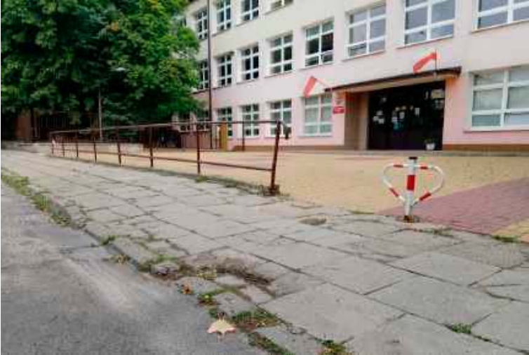
Połamany, niebezpieczny chodnik zostanie naprawiony jeszcze w wakacje
