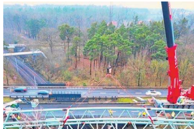
Kładka pieszo-rowerowa na Fordońskiej nad magistralą już jest gotowa. Trwają pozostałe prace, które powinny zakończyć się do końca maja
