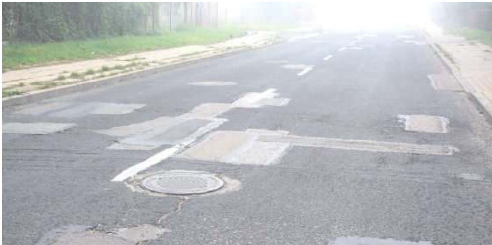
Mieszkańcy ulicy Sitnickiej apelują o modernizację drogi. Według nich stan ulicy pogarsza się z dnia na dzień.
