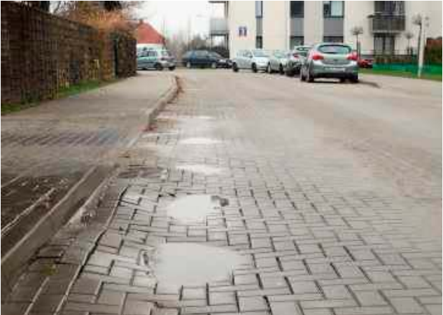
W przypadku ulicy Jemiółowej, dopiero po interwencji radnej Suchanowskiej, miasto wyegzekwowało naprawę uszkodzonej przez niego ulicy
