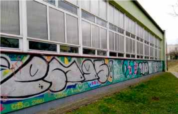
Pomazana elewacja najwyraźniej nie wszystkim przeszkadza
