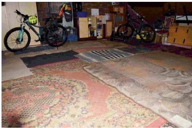
Nierówna podłoga na strychu wyrównywana dywanami przez mieszkańców
