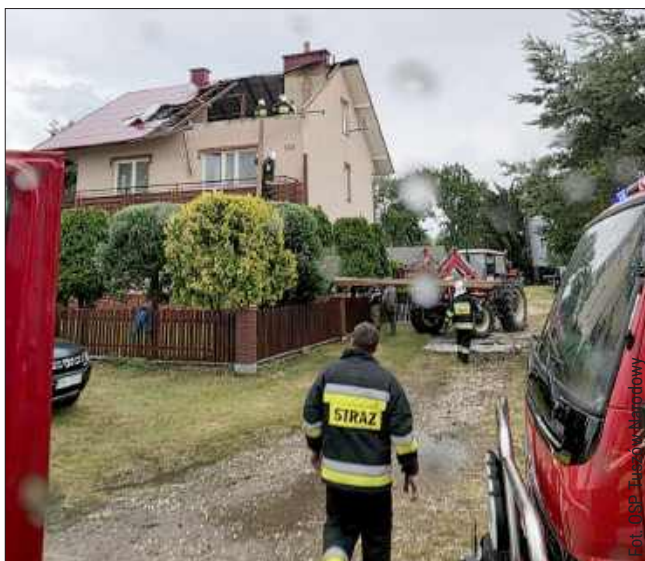
Wichura uszkodziła część dachu na budynku mieszkalnym.
