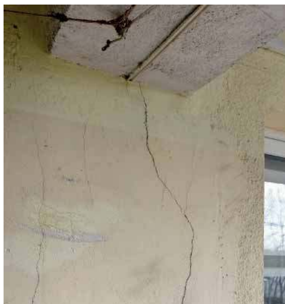
Ściany w bloku pękają
