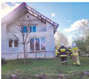
Strażacy 8 razy interweniowali przy uszkodzonych dachach.
