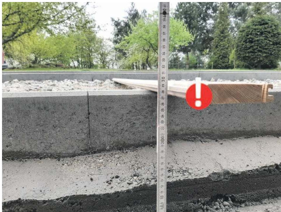
To uniemożliwiałoby mieszkańcom wyjazd z garażu, ale po naszej interwencji udało się usunąć problem
