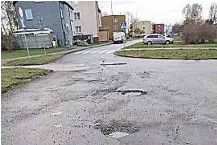
Dziury w „centrum” osiedla przy ul. Leśnej
